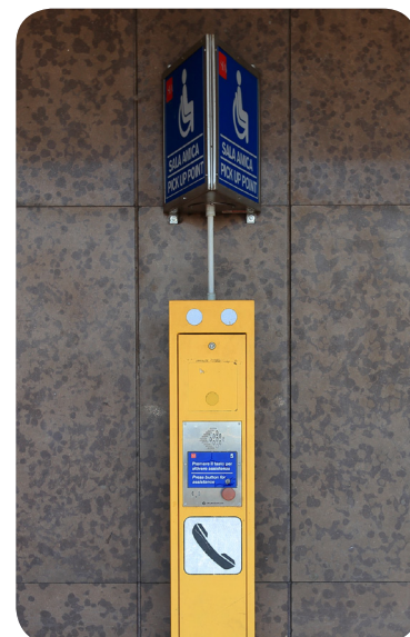
Citofono 'Sala Amica' pick up point
